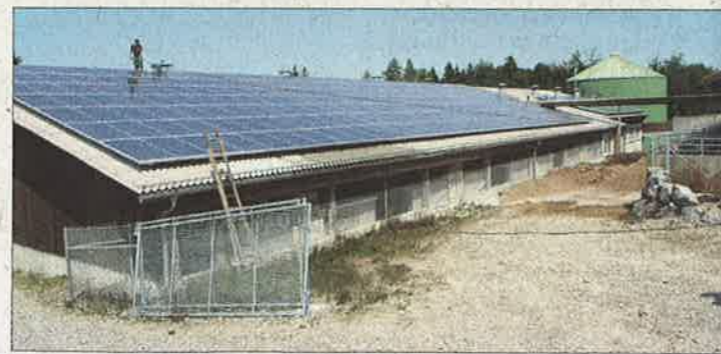
Das Solardach in Amlikon Bissegg TG. Links ist gereinigt, rechts ist der Schmutz noch sichtbar.
